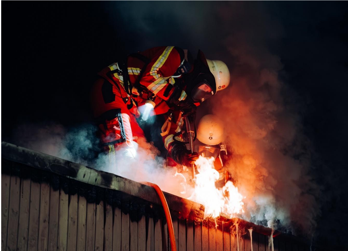
Beim Brand am Kindergarten-Neubau in Erdweg wurden die Fassade sowie Teile des Dachstuhls in Mitleidenschaft gezogen – 10.10.2024
