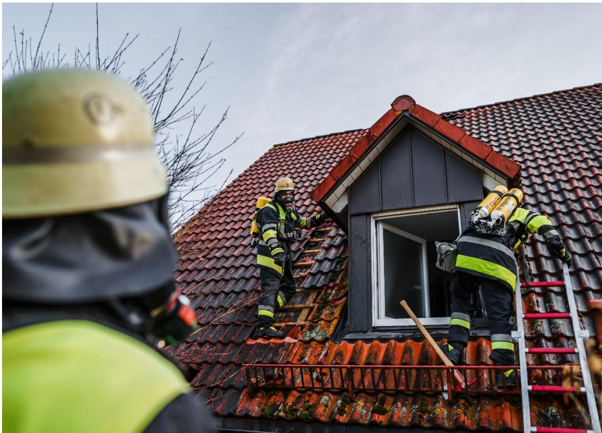
Nach dem Übergriff eines Feuers auf den Dachstuhl einer Doppelhaushälfte in Gumpersdorf musste die Dachhaut geöffnet werden – 02.03.2024
