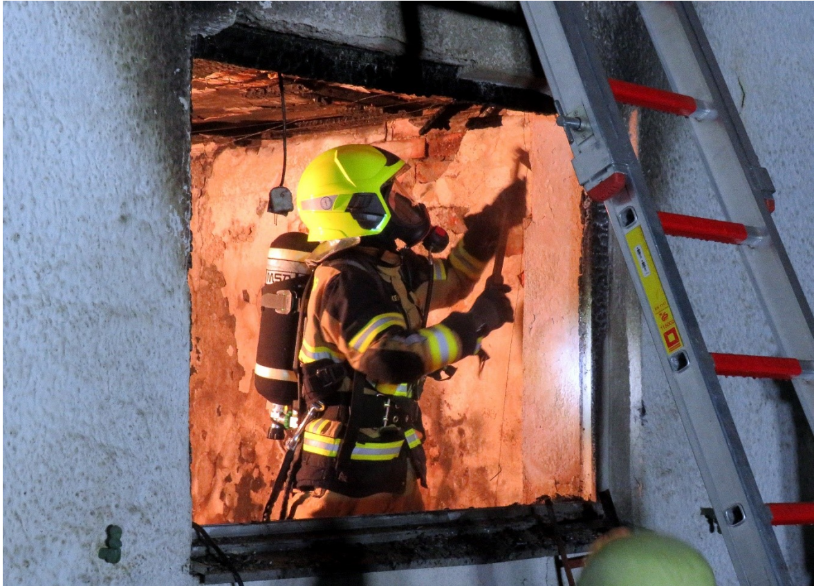
Nach einem Zimmerbrand in Glonn musste der Fehlboden geöffnet werden um versteckte Glutnester abzulöschen – 02.09.2020
