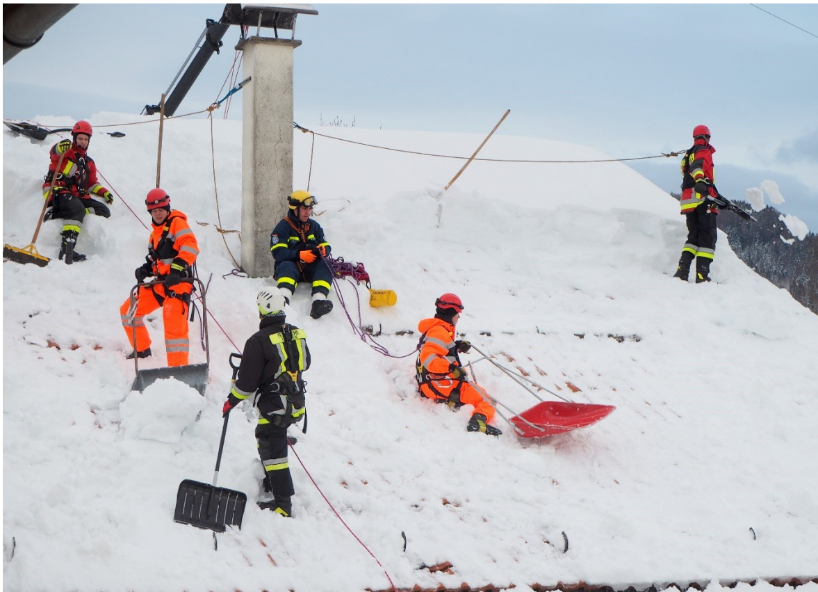
Sicherungen gegen Durchbruch und Abrutschen auf dem Satteldach einer Firma in Hausham – 15.01.2019
