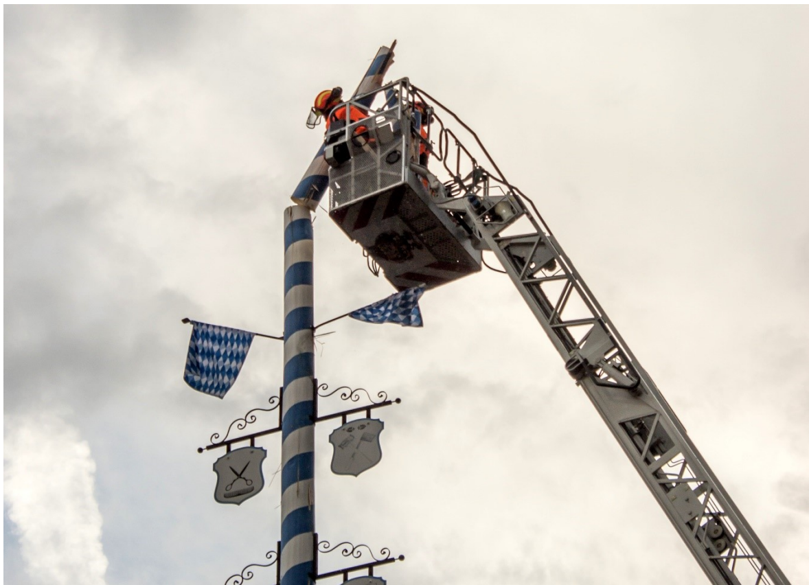
Nach einem Blitzeinschlag muss die Spitze des Maibaums in Oberroth von der Feuerwehr Dachau mit der Drehleiter abgetragen werden – 13.05.2018
