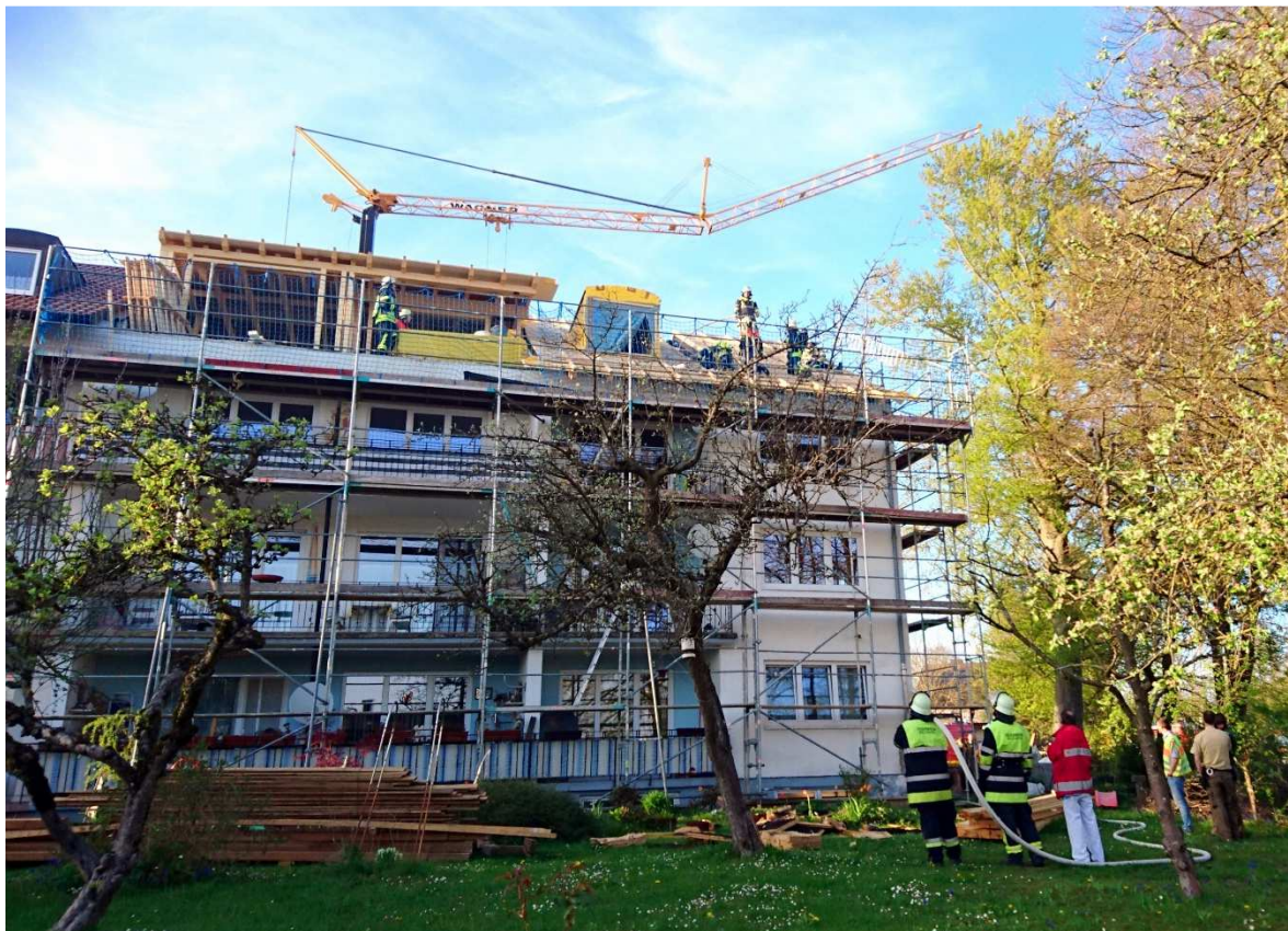
Dachstuhlbrand bei Bauarbeiten an einem Mehrfamilienhaus in Odelzhausen – 21.04.2016
