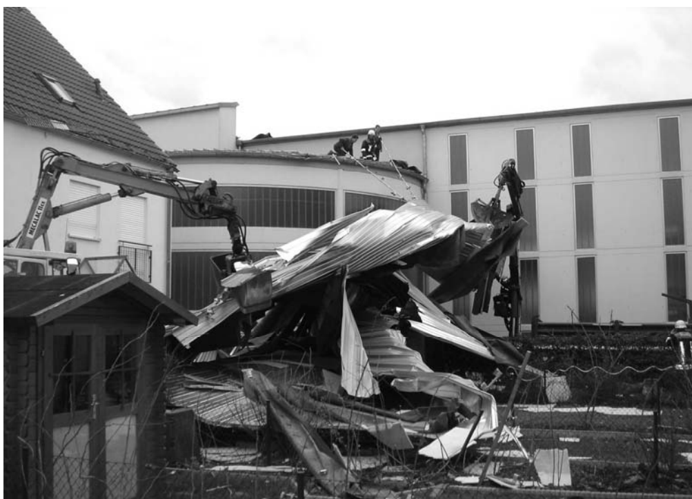
Im Januar 2007 beschäftigte die Feuerwehren im Landkreis mit einer Vielzahl von Einsätzen – hier die FF Karlsfeld bei einem abgedeckten Parkhausdach
